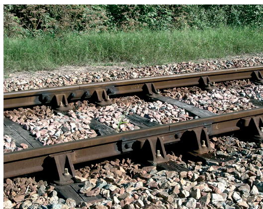
Photo 1 – Tronçon de voie entre Tours et Loches, au niveau d'Esvres : rail double champagne (42,540 kg/m), coussinets en fonte avec quelques tire-fonds manquant, traverses en bois entaillées à plat. Photo Jean-Louis Jung
