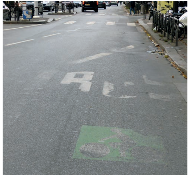
Signalisation effacée - rue de la Chapelle Paris
